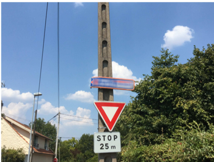
Dispositifs installés sur poteau de transport électrique - rue Boissière, Combs-la-Ville, 08/2018
