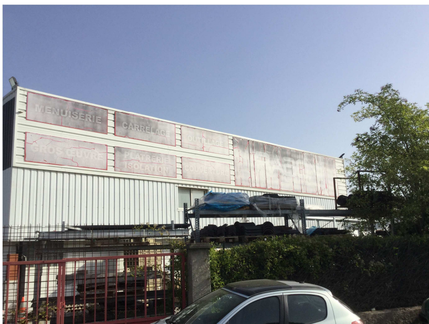
Enseignes en mauvais état d'entretien - Rue Jean Rostand, Combs-la-Ville, août 2018
