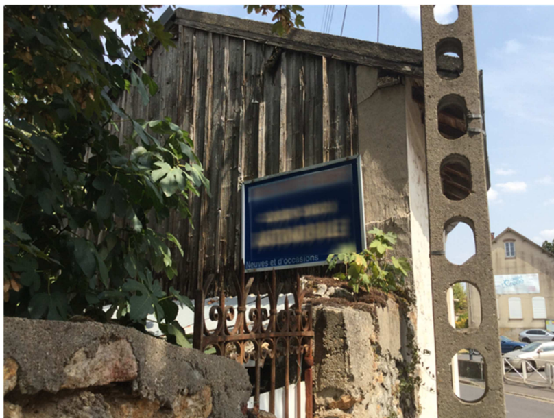
Dispositif en mauvais état d'entretien – rue Sommeville, Combs-la-Ville, 08/2018
